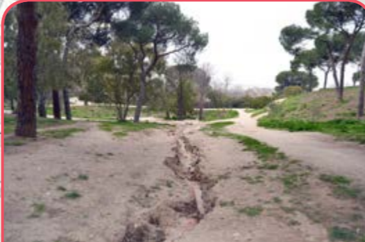
Imagen 5.5 Erosión severa en el final de la línea de drenaje
