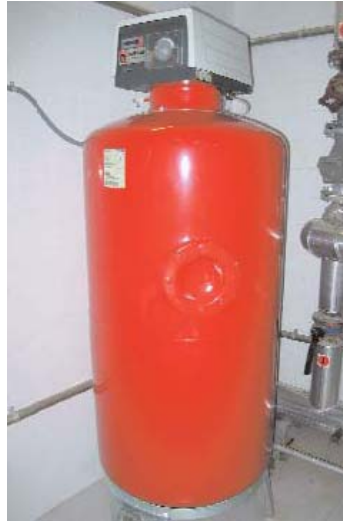
Vaso de expansión cerrado de un sistema de calefacción
