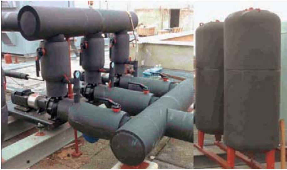
Instalaciones con aislamiento térmico en tuberías y tanques (Fuente: Soluciones energéticamente eficientes en la edificación del IDAE)
