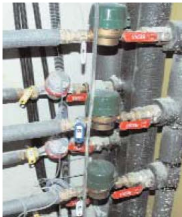
Ejemplo de conjunto de contadores de una instalación de ACS y agua fría
