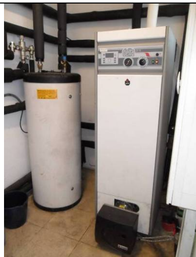
Caldera y Acumulador. Pistas de Pádel
