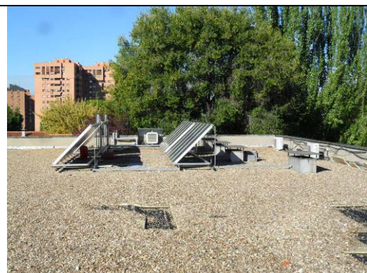
Instalación solar térmica. Piscina Cubierta
