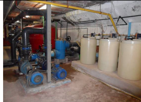
Bombas. Piscina Cubierta
