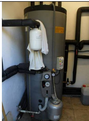
Acumulador Solar ACS. Pistas de Pádel
