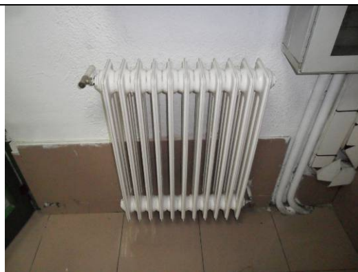
Radiador. Vestuarios Piscina
