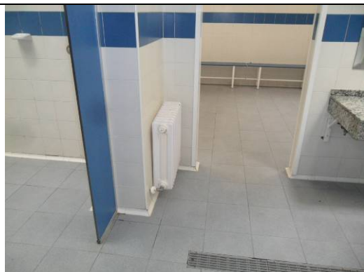
Radiadores. Vestuarios Pabellón
