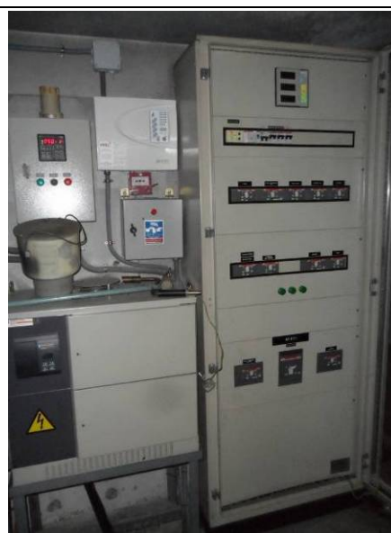
Cuadro General y Batería de Condensadores
