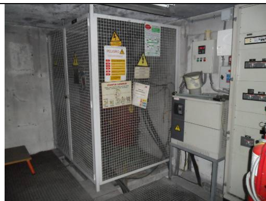
Centro de Transformación
