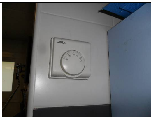
Termostato. Vestuarios Pistas de Pádel
