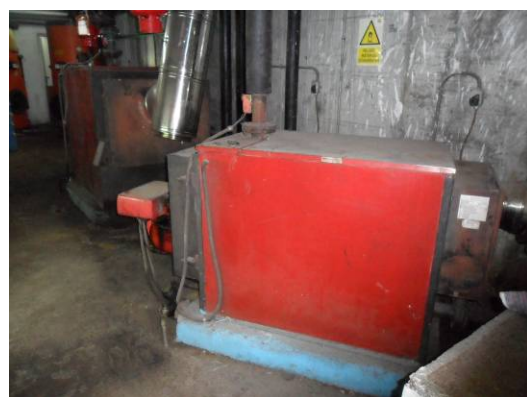
Calderas. Piscina Cubierta
