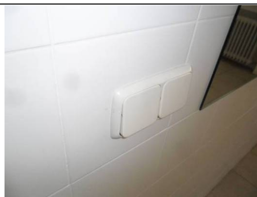
Interruptores. Vestuarios Tenis
