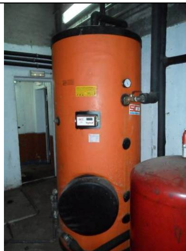
Acumulador. Piscina cubierta
