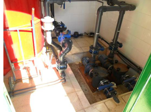
Bombas. Piscina Chapoteo
