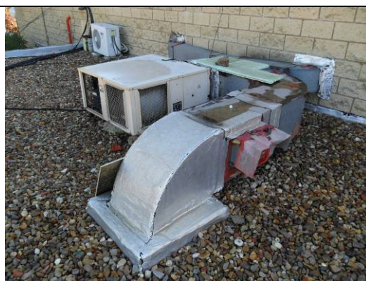
Equipos Autónomos. Oficinas
