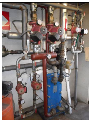
Bombas de calefacción y ACS Pabellón
