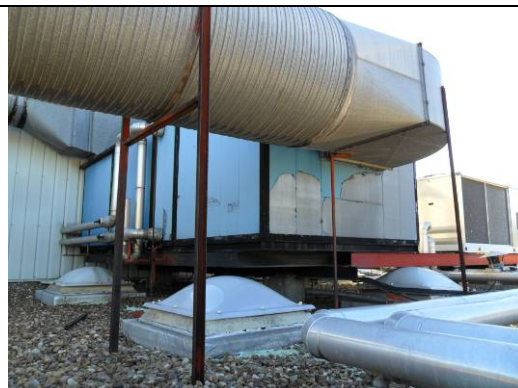
Bomba de calor. Pabellón
