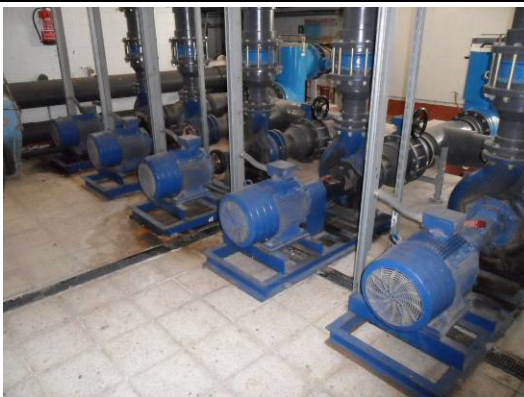
Bombas. Piscina Olímpica y mediana
