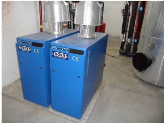
Sala calderas Campo de Futbol
