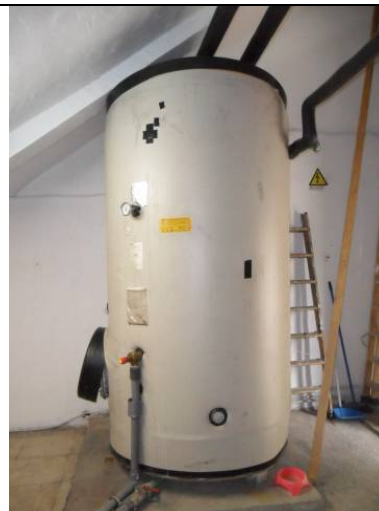
Acumulador ACS Pabellón Polideportivo
