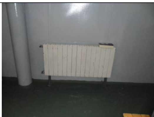
Radiador de agua de los vestuarios del Campo de Fútbol
