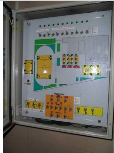
Cuadro control de iluminación de piscina, pabellón y pistas exteriores
