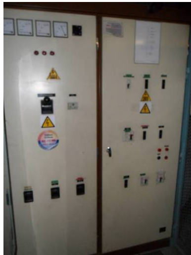
Cuadro general de baja tensión
