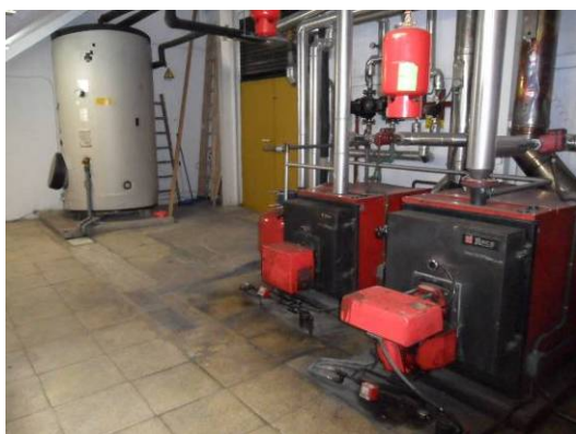
Sala calderas Pabellón Polideportivo
