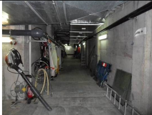
Iluminación galería sótanos
