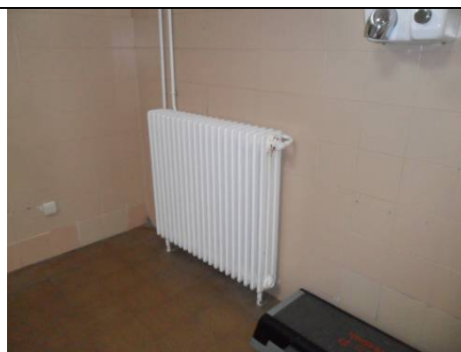
Radiador de agua de los vestuarios de Piscina Cubierta
