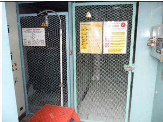
Centro de Transformación
