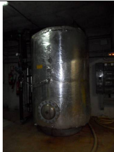
Acumulador ACS Piscina Climatizada
