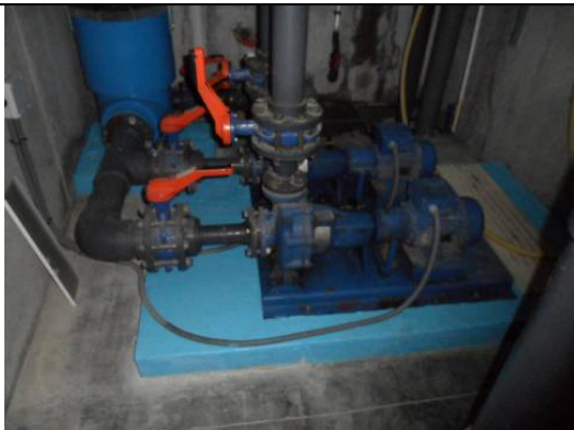
Bombas depuración piscina enseñanza
