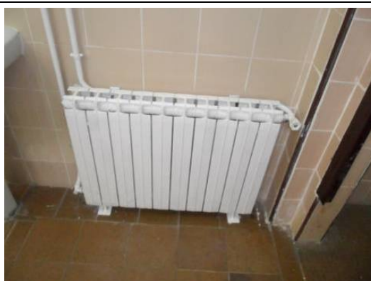
Radiador de agua de los vestuarios del Pabellón Polideportivo
