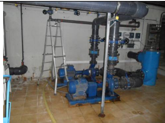
Bombas depuración piscina 25m
