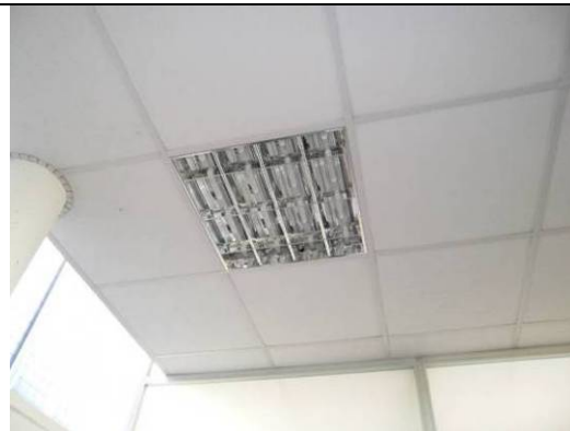
Fluorescente 4x18 W. Oficinas
