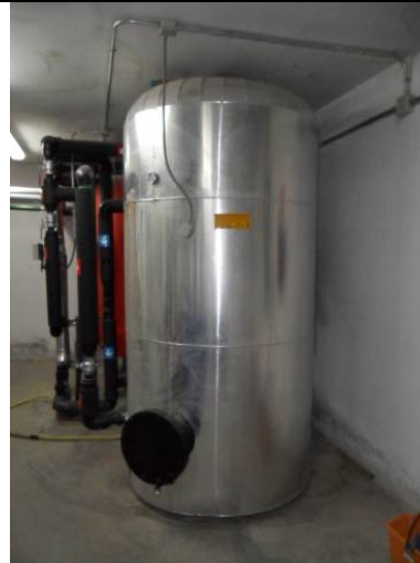
Acumulador ACS Campo de Futbol
