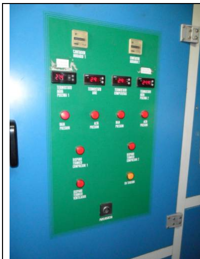
Temperaturas de los termostatos de aire y agua de la Piscina Cubierta
