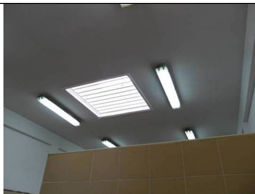
Iluminación vestuarios Pabellón
