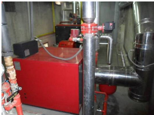
Sala calderas de Piscina Climatizada
