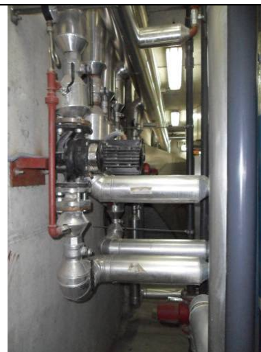
Batería de calor de la deshumectadora de la Piscina Cubierta
