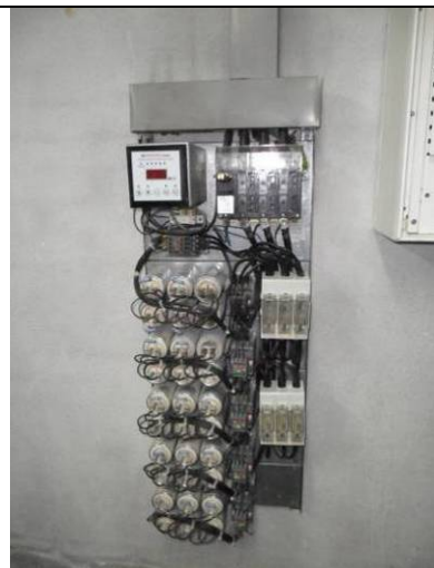
Batería de Condensadores
