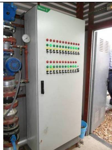
Cuadro Control Sala de Calderas
