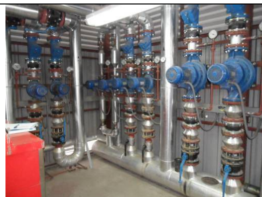
Bombas Sala calderas.
