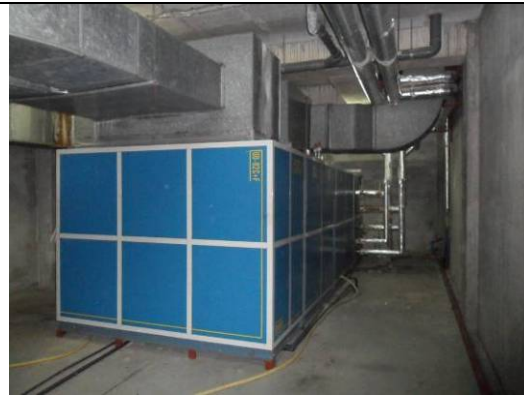
Deshumectadora de Aire de Piscina
