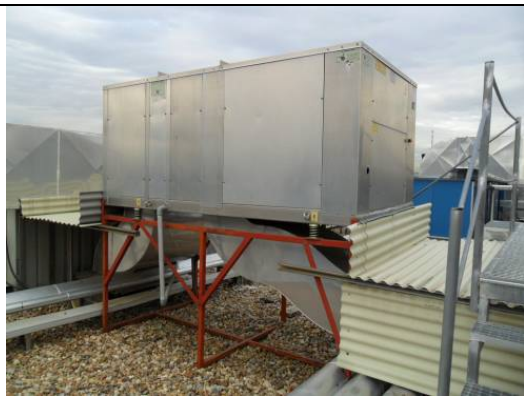
Bomba de Calor
