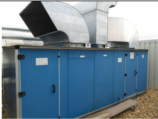
UTA en cubierta del Edificio
