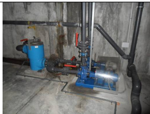
Bombas. Piscina infantil
