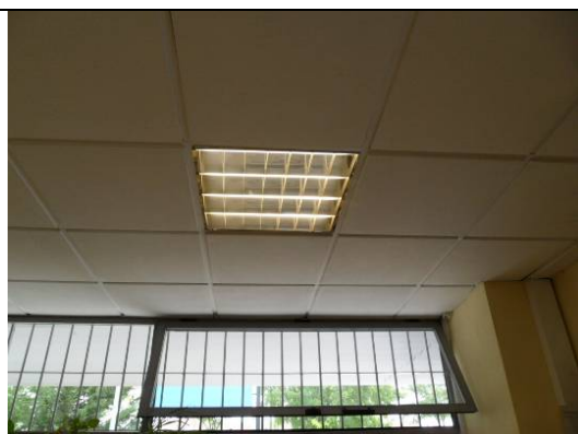
Iluminación Oficina – Fluorescentes 4x18W.
