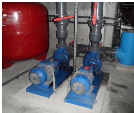
Bombas. Piscina 25m
