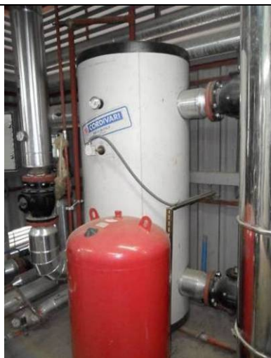
Depósito Inercia Calentamiento Piscina
