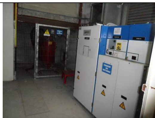
Centro de Transformación
