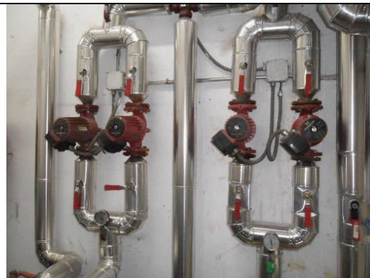
Bombas de calefacción y ACS
