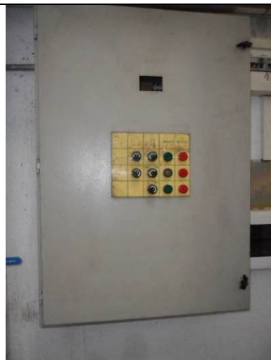
Cuadro control bombas y caldera
