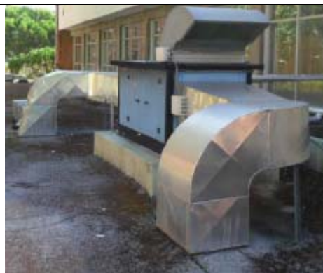
Climatizador cubierta piscina
