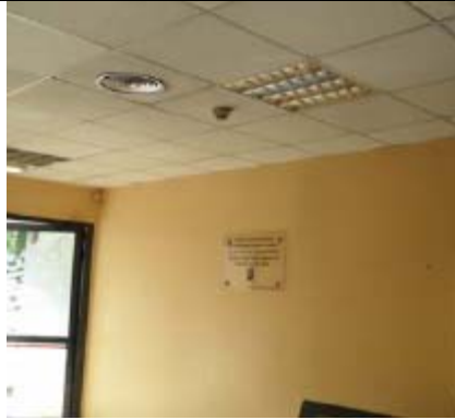
Luminarias fluorescentes 4 x 18 W en zonas iluminadas sin detector (en este caso funcionando también por la noche)
