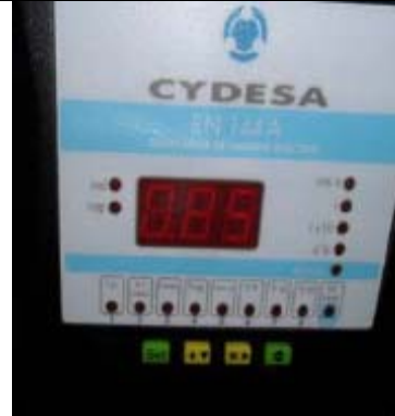
Display batería de condensadores, apagada
