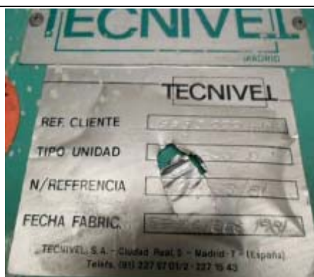
Placa características técnicas climatizadora piscina
