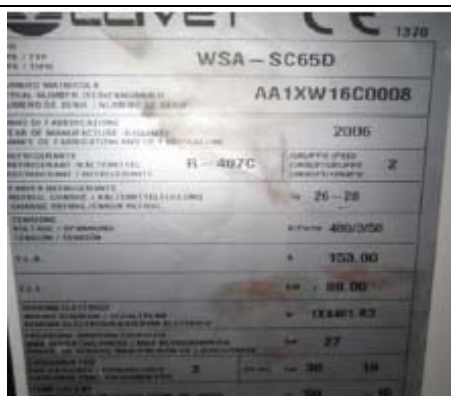
Placa características técnicas enfriadora CLIVET
