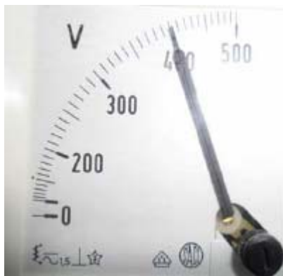
Tensión de alimentación, sin margen de ajuste
