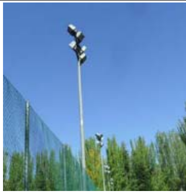
Luminarias exteriores tipo HM (prob. 250 W)
