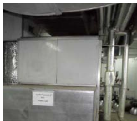
Climatizador zona pabellón Antonio Mata
