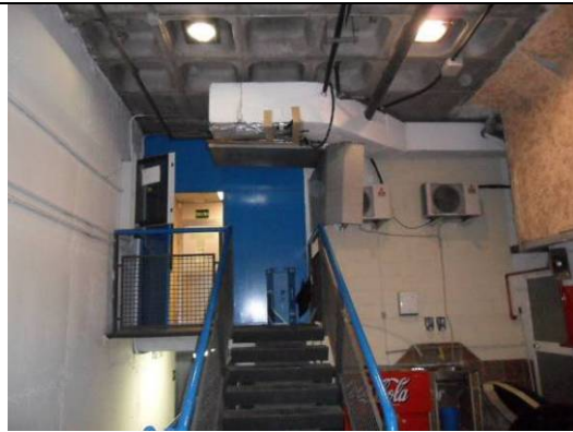
Equipos autónomos. Oficinas
