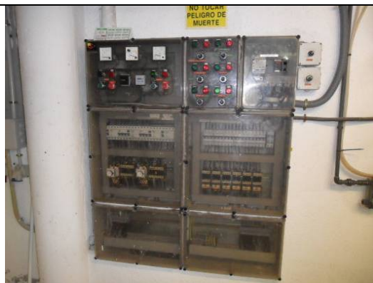
Cuadro eléctrico. Depuración Piscina
