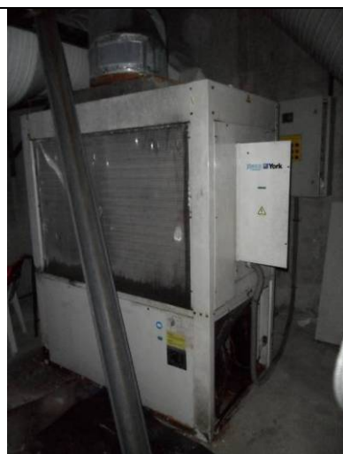
Bomba de Calor
