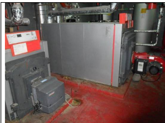
Calderas Pabellón y Piscina
