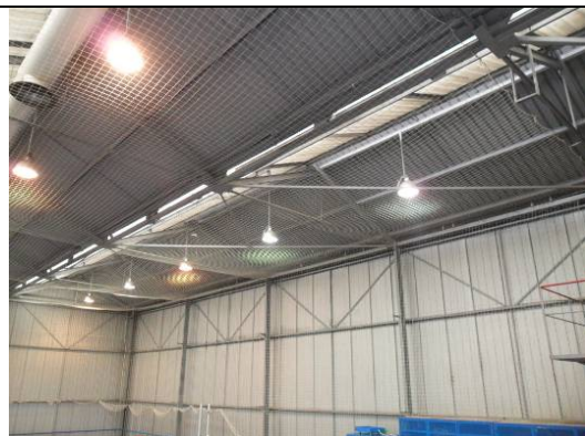
Iluminación Pabellón Polideportivo
