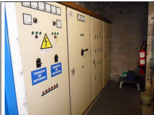
Cuadro General de Baja Tensión
