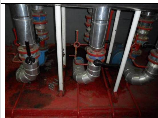
Bombas piscina y climatizadoras
