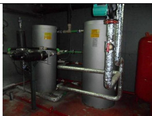
Acumuladores de ACS
