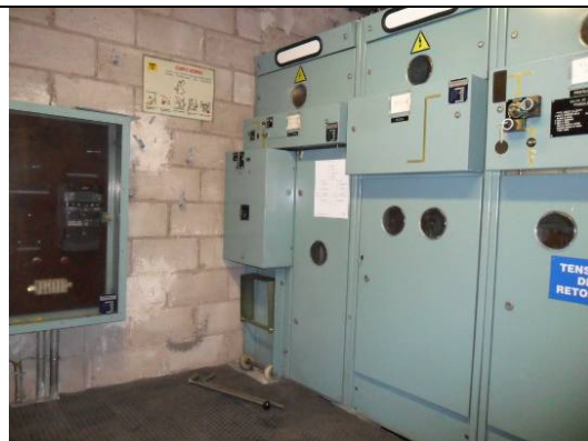
Centro de Transformación
