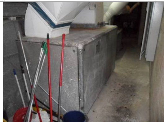
Climatizador Vestuarios Piscina
