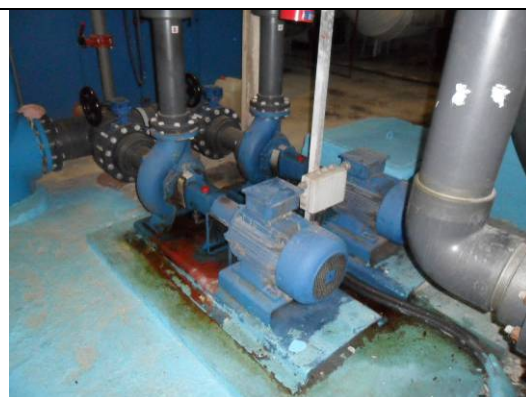
Bombas de Piscina Cubierta
