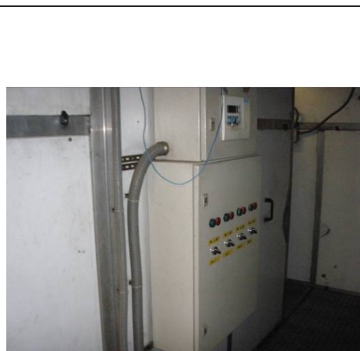
Cuadro de control
