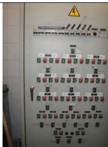
Cuadro Control Sala de Calderas
