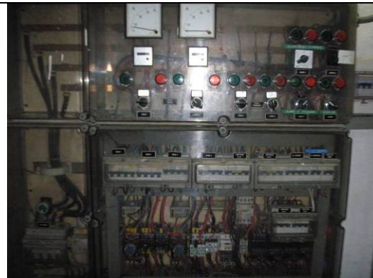
Cuadro control. Bombas Piscina Cubierta
