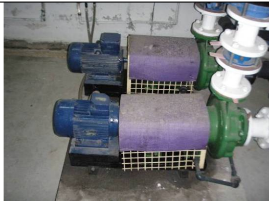
Bombas. Piscina 25m
