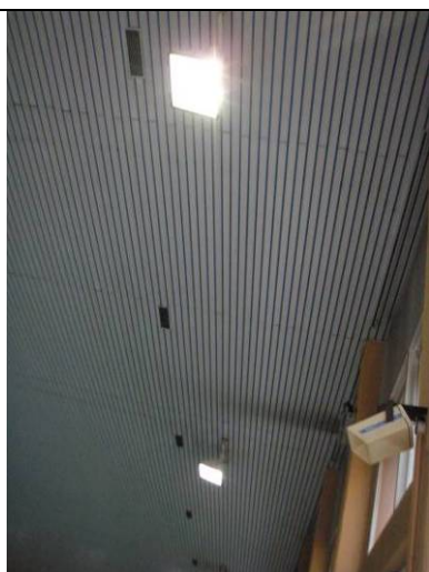
Iluminación Piscina Cubierta
