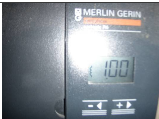
Batería de Condensadores
