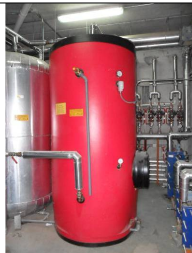
Acumuladores Sala de Calderas
