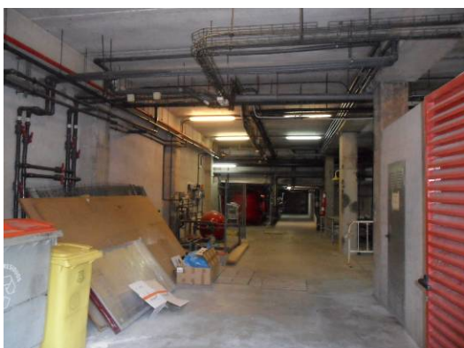
Iluminación Sala Depuración
