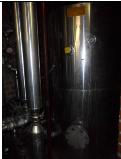
Acumulador Caldera Pabellón
