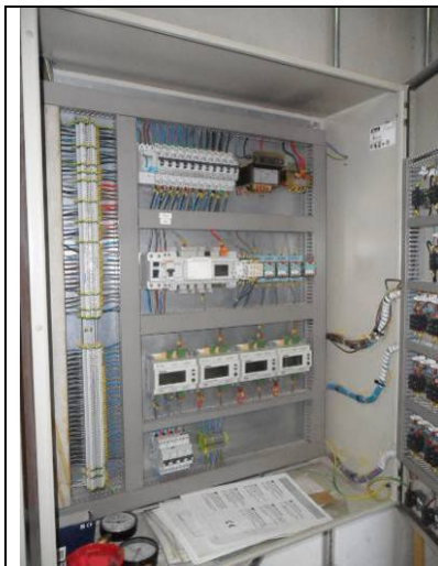
Cuadro eléctrico Sala de Calderas
