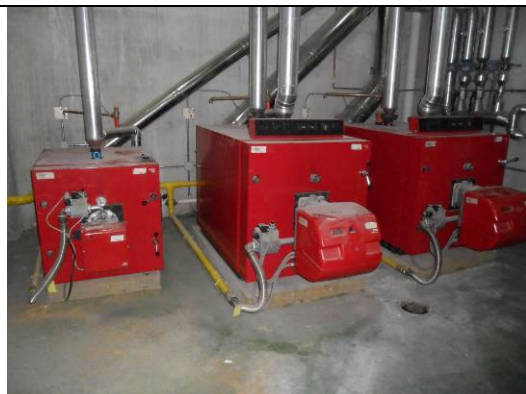
Sala de Calderas
