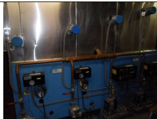
Sala Calderas Pabellón
