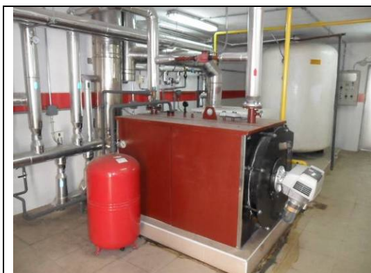
Caldera Mixta. Vestuarios personal y oficinas
