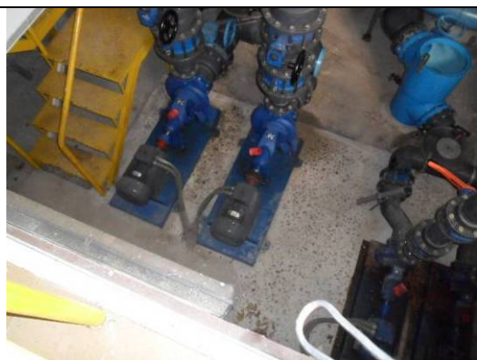
Bombas. Piscina Olímpica
