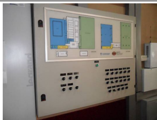
Control de Iluminación. Pabellón Polideportivo y Piscina Cubierta
