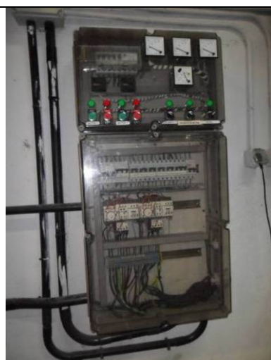
Cuadro Bombas. Piscina Cubierta
