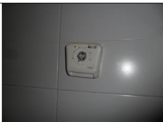
Termostato. Vestuarios Piscina
