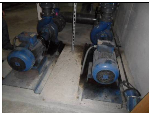
Bombas. Piscina Cubierta 25 m
