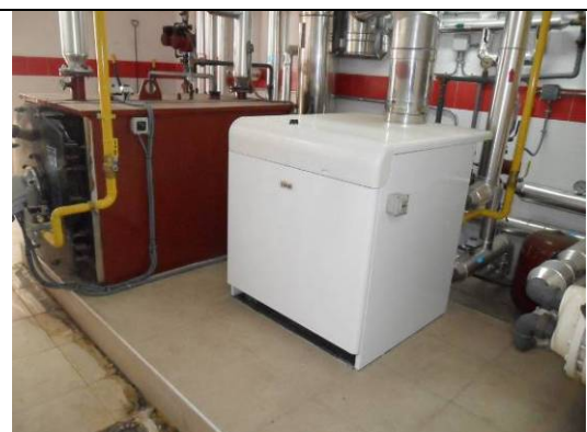
Caldera ACS. Vestuarios personal y oficinas
