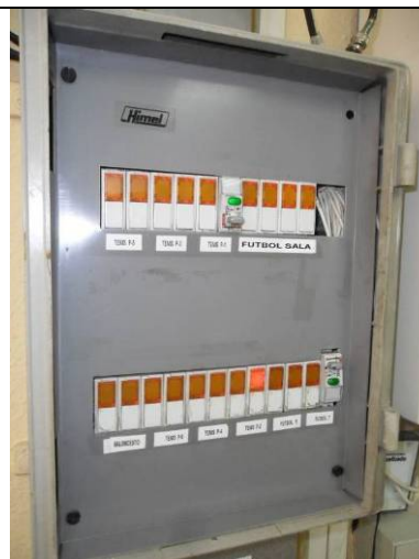
Control de Iluminación. Pistas Exteriores
