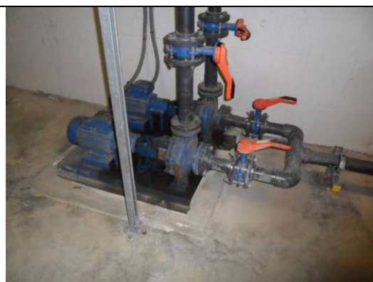
Bombas. Piscina Cubierta Enseñanza
