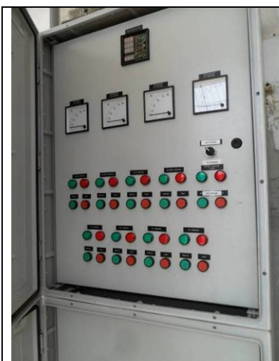
Cuadro Bombas. Piscina Verano
