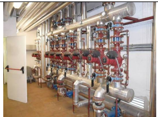
Bombas Calefacción y ACS
