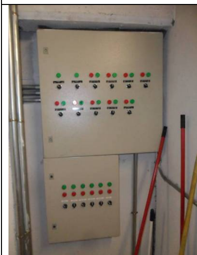
Cuadro Sala Calderas. Piscina y Pabellón
