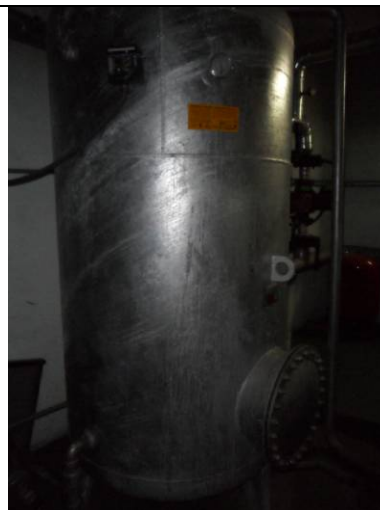
Acumulador Sala de Calderas
