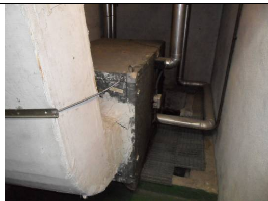
Climatizadora vestuario Piscina
