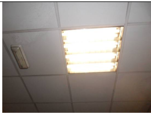
Iluminación vestuario personal
