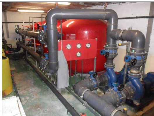
Depuración y tratamiento de aguas Piscina
