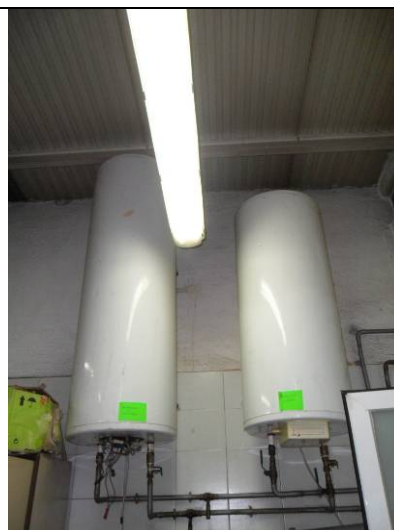
Termo acumuladores Vestuario Personal
