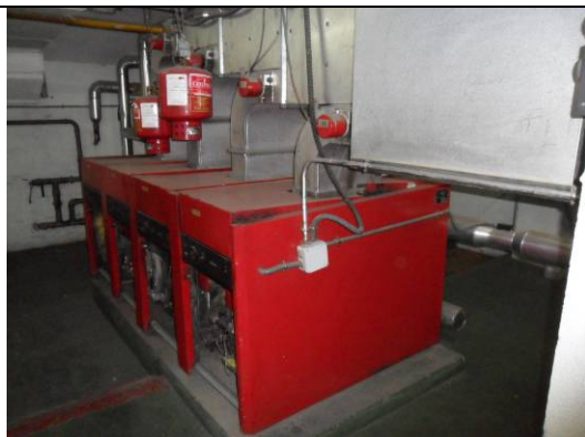
Sala de Calderas
