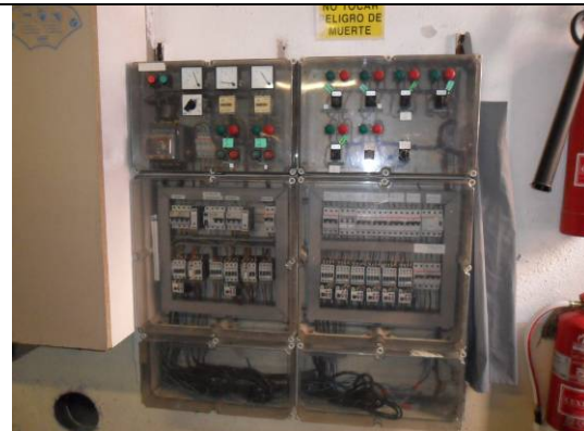
Cuadro control bombas
