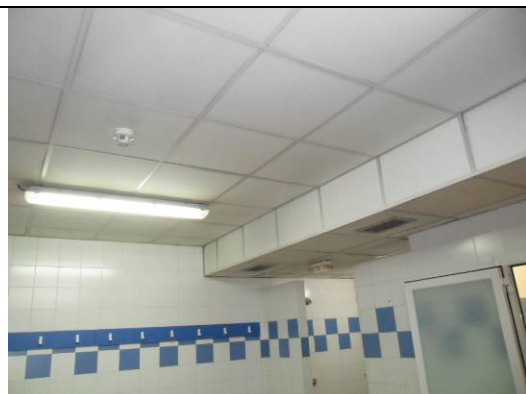
Iluminación Vestuarios Exteriores
