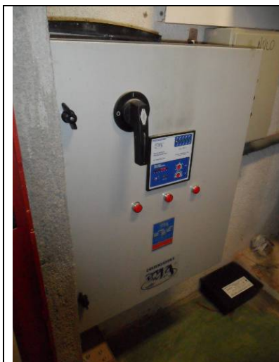
Batería de condensadores
