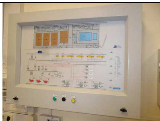
Botonera de control de iluminación de Piscina y Pabellón
