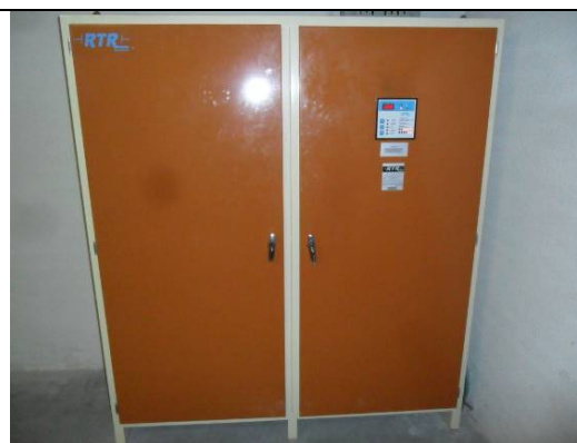
Batería de condensadores
