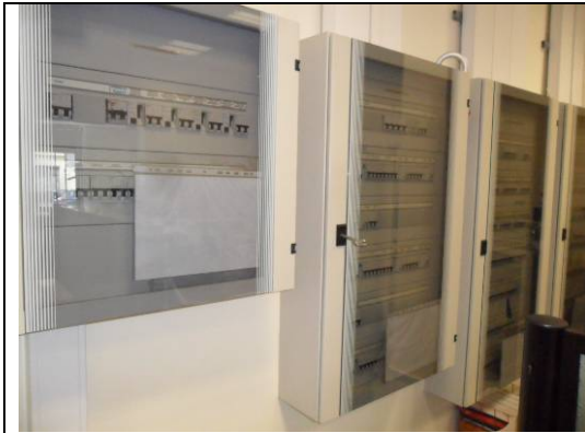
Cuadro eléctrico secundario. Piscina Cubierta
