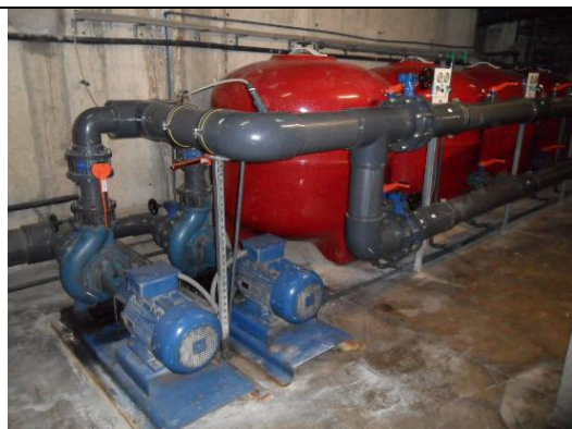
Bombas. Piscina 25m
