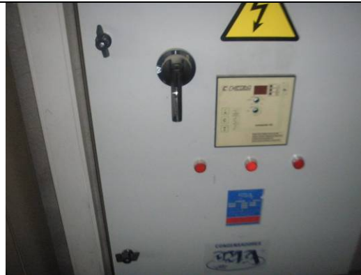
Batería de condensadores
