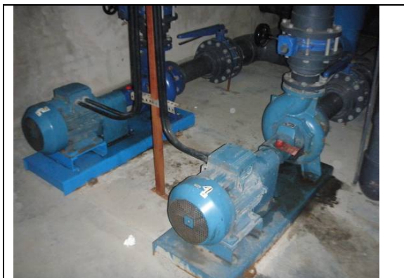
Depuración piscina cubierta
