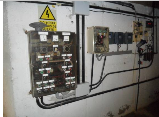
Cuadro control. Bombas
