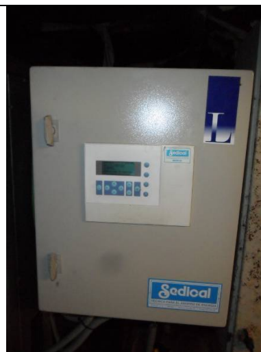
Centralita de climatización. Piscina
