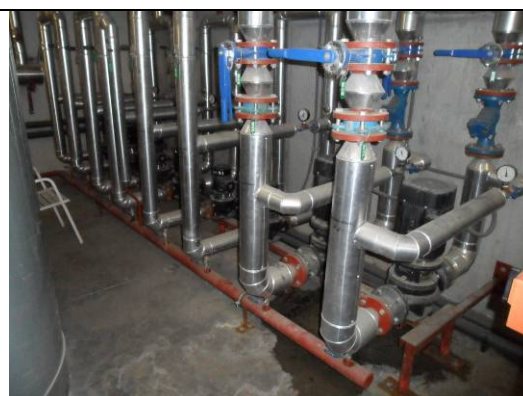
Bombas Sala de Calderas
