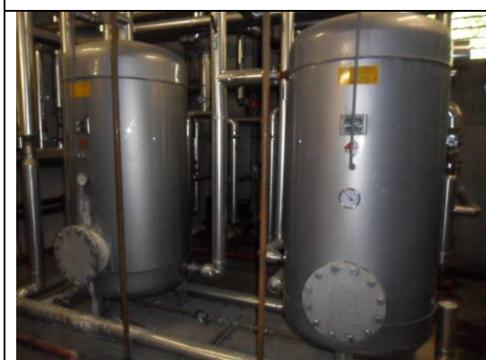
Acumuladores Sala de Calderas
