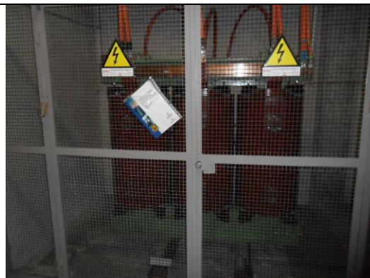
Centro de Transformación
