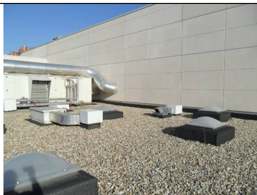
Climatizadora vestuarios Piscina
