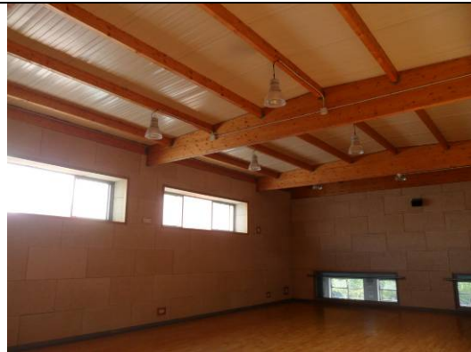
Iluminación Sala Aerobic
