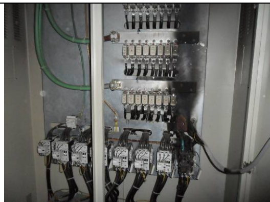
Batería de condensadores
