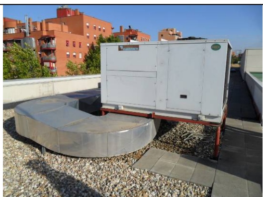
Bomba de calor Vestíbulo
