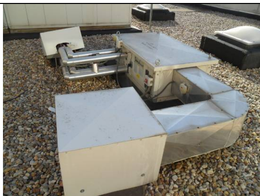
Climatizadora vestuarios 1 y 2 de Pabellón
