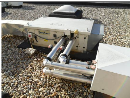
Climatizadora vestuarios 3 y 4 de Pabellón
