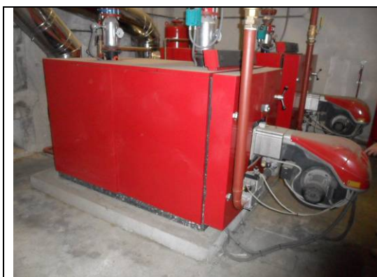
Sala de Calderas
