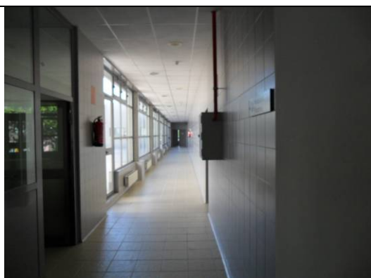
Radiadores planta baja
