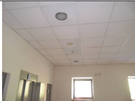
Iluminación Planta baja
