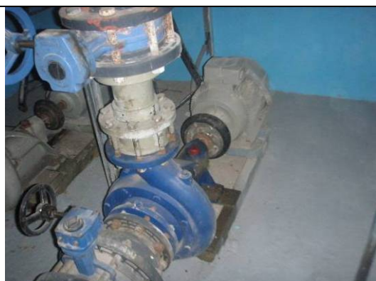
Depuración piscina cubierta
