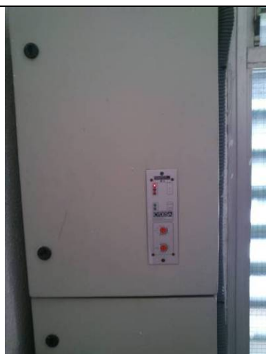
Batería de Condensadores
