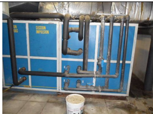
Climatizadora deshumectadora Piscina Cubierta
