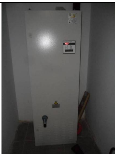
Batería de condensadores
