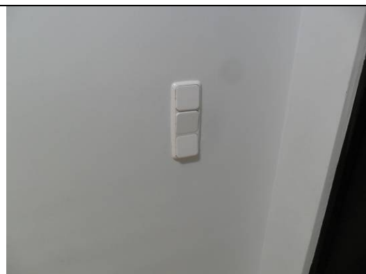
Interruptor manual. Sala multiusos del Pabellón
