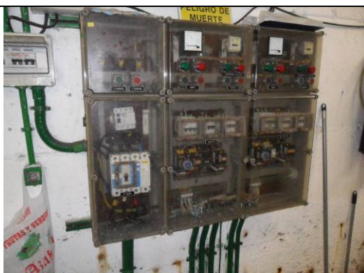
Cuadro eléctrico. Piscinas de verano
