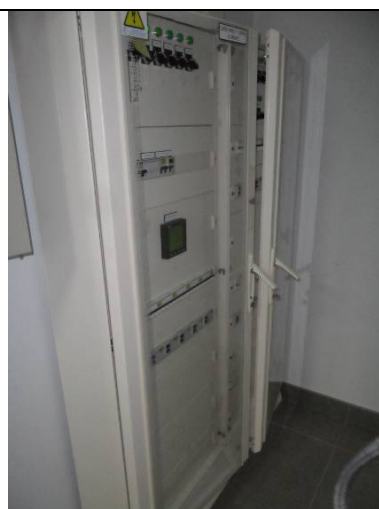
Cuadro mando y control alumbrado. Pabellón
