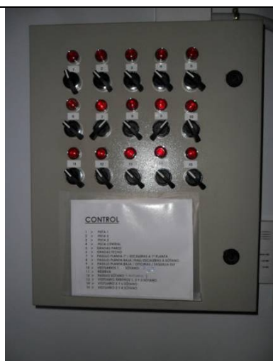
Cuadro control iluminación. Pabellón
