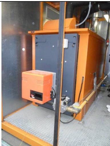
Caldera Pabellón Polideportivo
