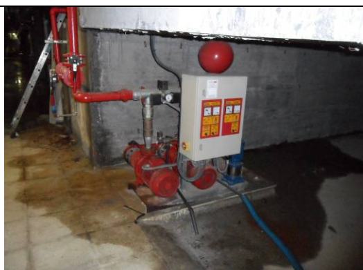
Contraincendios Piscina Cubierta
