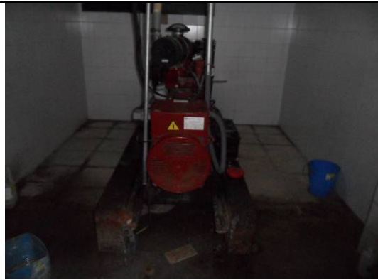
Grupo Electrógeno. Piscina Cubierta.
