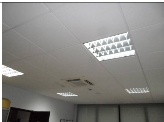
Iluminación Oficinas. Pabellón
