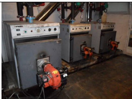
Caldera Piscina Cubierta
