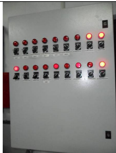
Cuadro control. Calefacción y ACS. Pabellón
