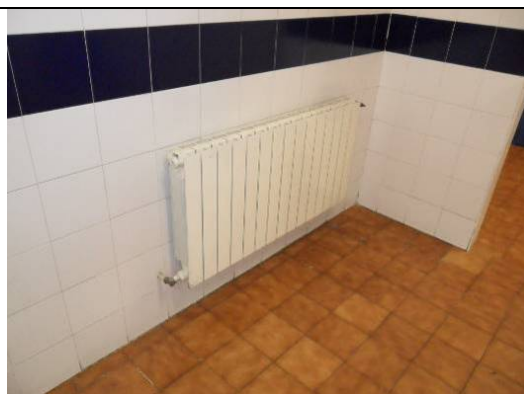
Radiadores de agua
