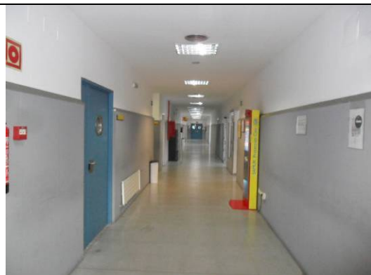
Iluminación pasillos. Planta Baja
