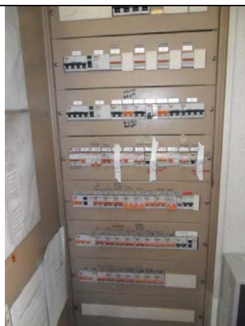
Cuadro Eléctrico. Taquilla
