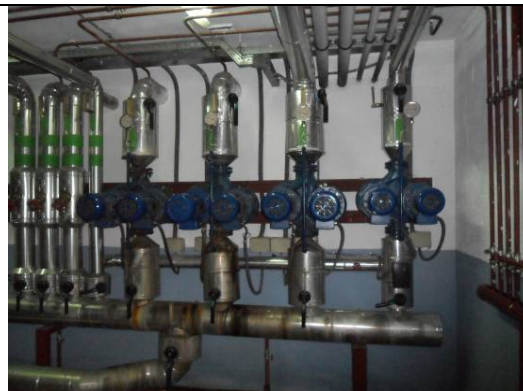
Bombas de calefacción y ACS
