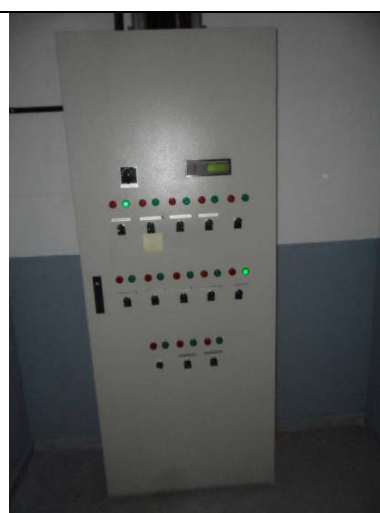
Cuadro control. Climatizadoras
