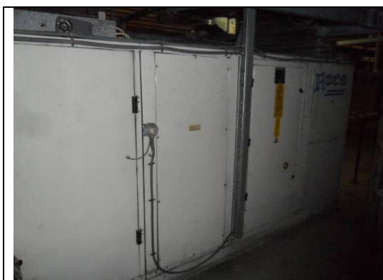
Bomba de Calor. Piscina
