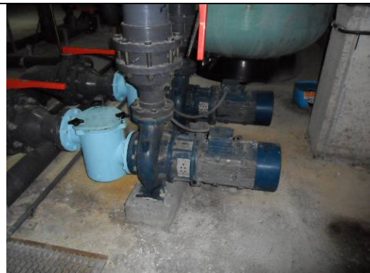
Bombas. Piscina Cubierta
