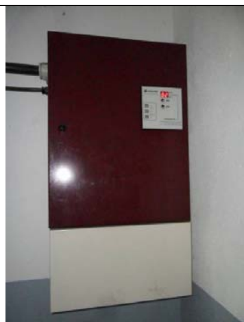
Batería de Condensadores
