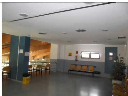
Iluminación. Pasillos. 1ª Planta
