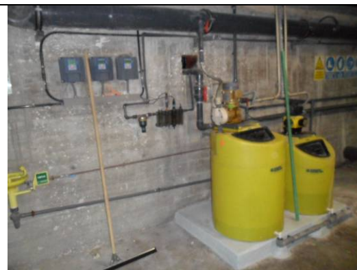
Tratamiento de aguas Piscina
