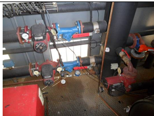
Bombas Sala Calderas Pabellón
