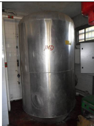
Acumulador Caldera Piscina de Verano
