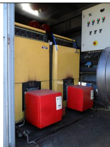
Sala Calderas Pabellón
