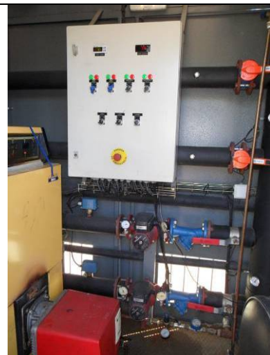
Cuadro control Sala Calderas Pabellón
