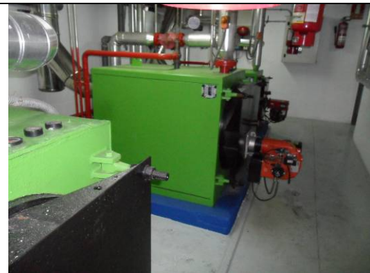
Sala de Calderas Piscina
