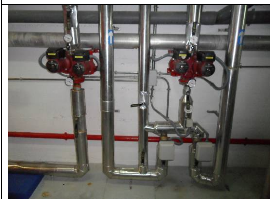
Bombas Sala de Calderas Piscina
