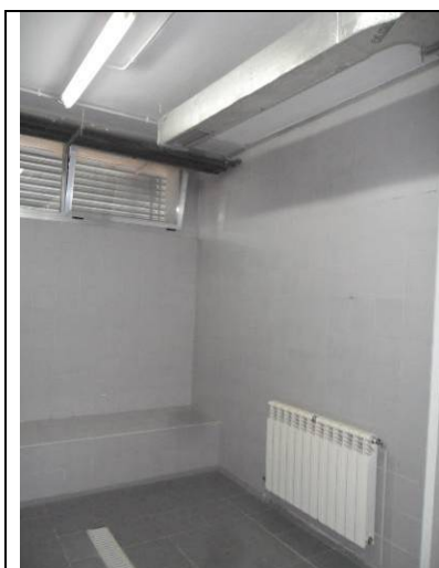
Iluminación vestuarios Pabellón
