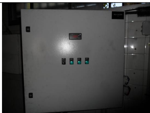
Cuadro control Caldera Piscina de Verano
