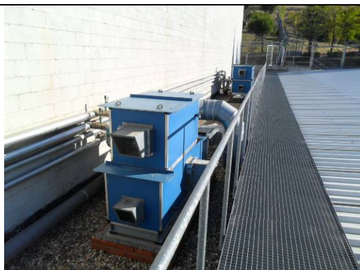
Climatizadoras Aeróbic y Sala de Musculación
