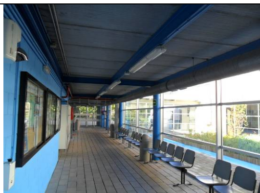
Iluminación pasillo Piscinas
