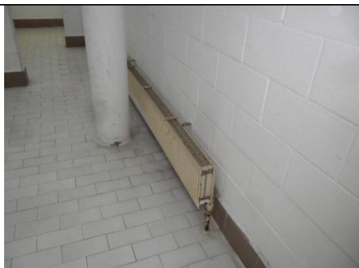
Radiadores vestuario Piscina
