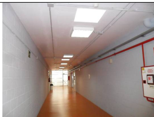
Iluminación Pasillos Pabellón
