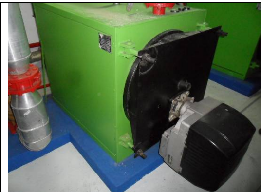
Sala de Calderas Piscina
