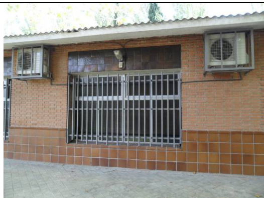
Equipo autónomo aulas
