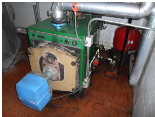
Caldera Piscina de Verano
