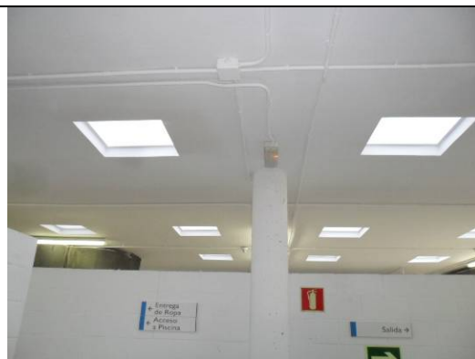
Iluminación vestuario Piscina
