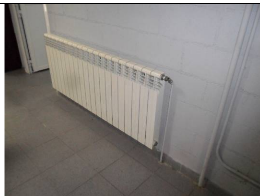
Radiadores vestuario Pabellón
