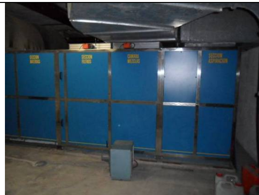
Deshumectadora apoyo piscina
