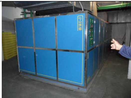
Deshumectadora principal piscina
