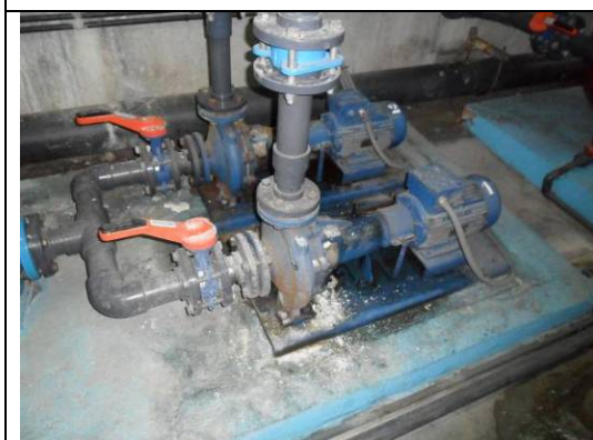
Bombas depuración piscina
