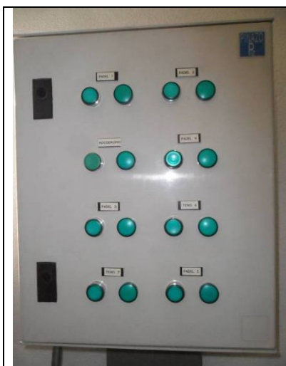
Botonera iluminación de pistas
