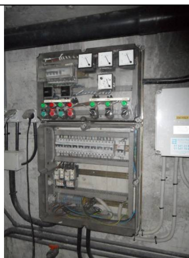
Cuadro bombas depuradora piscina
