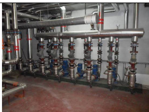
Bombas calefacción y ACS
