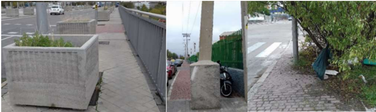
Imágenes del deterioro del espacio público del polígono
